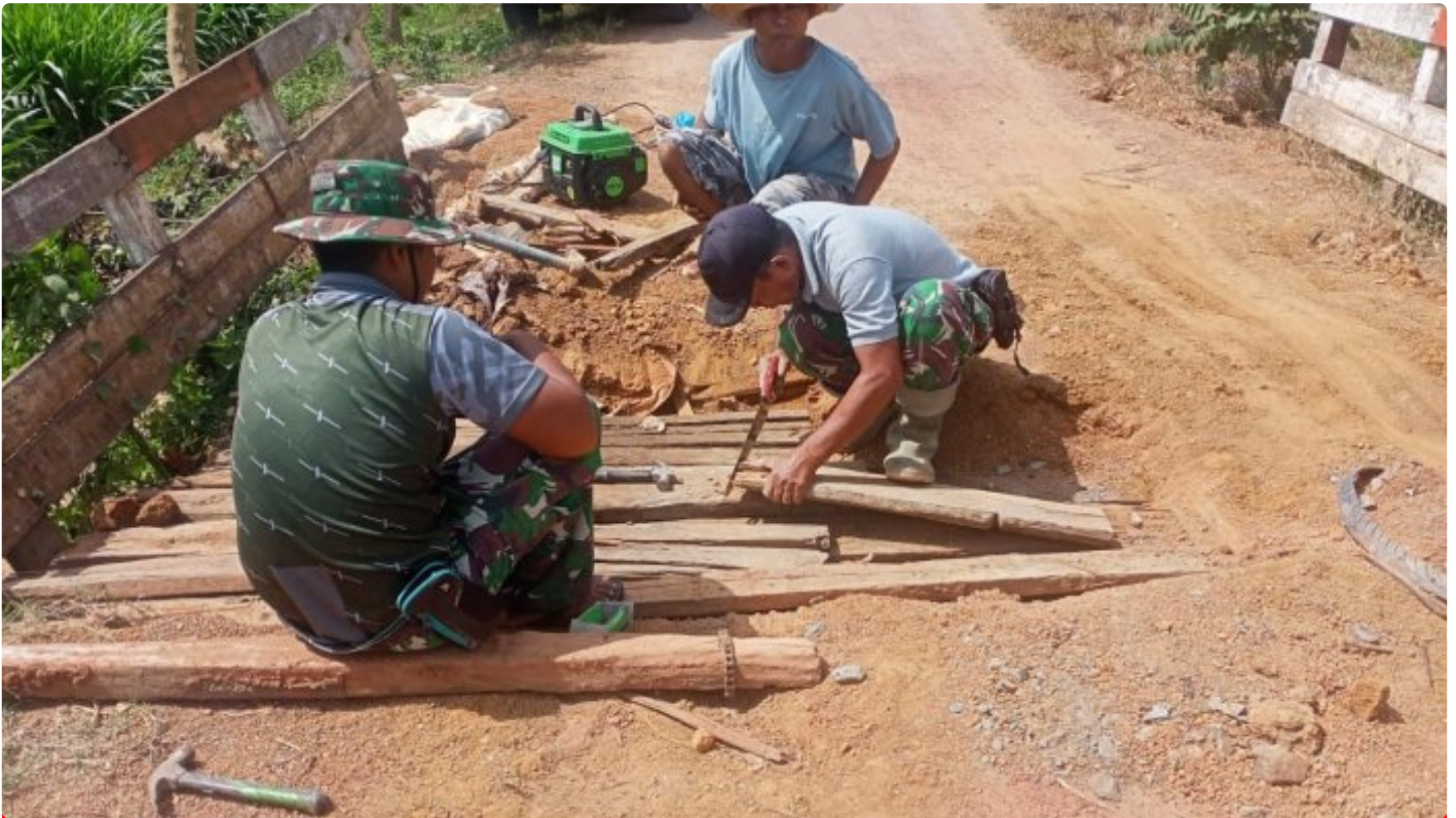
Ada Jalan Berlubang, Dengan Sigap Satgas TMMD Bertindak
